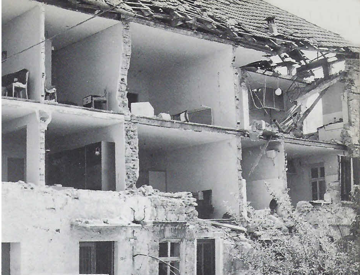
TARCENTO - La parete è crollata mostrando gli arredi interni della casa. La costruzione appare come un grande scaffale.
